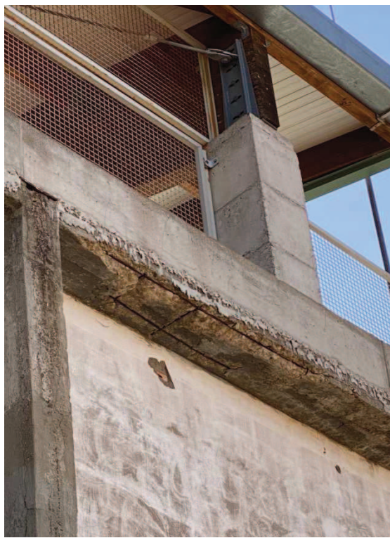
Imagen 3. Daños en viga de coronación con armaduras a la vista y con corrosión. Escaso recubrimiento y falta de goterón. Vista desde vivienda N° 22 C/ Fermín Arteta
