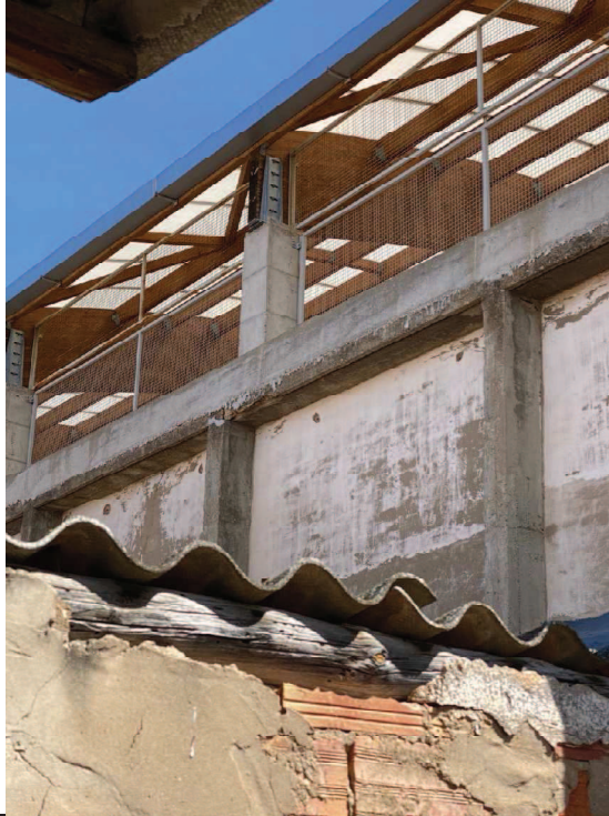
Imagen 5. Viga de hormigón con goterón longitudinal sobre vivienda N° 20 C/ Fermín Arteta
