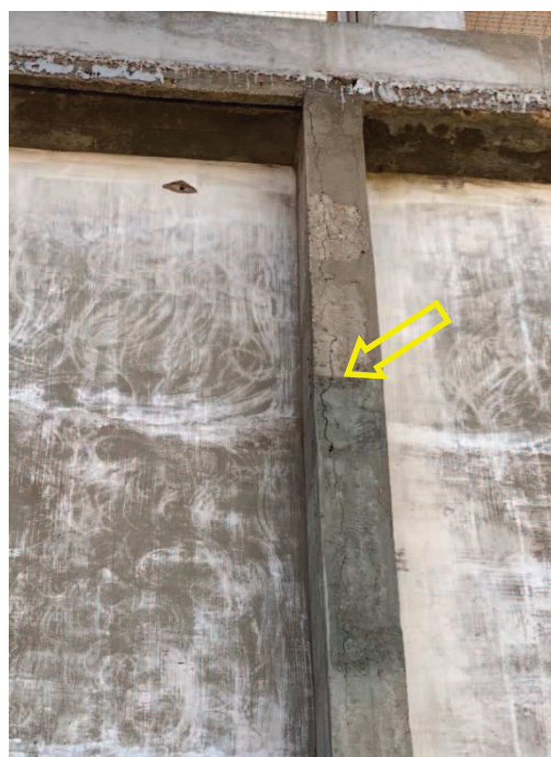
Imagen 4. Fisuras en hormigón en la dirección de la armadura longitudinal, vista desde vivienda N° 22 C/ Fermín Arteta
